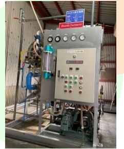
最近更新したガス発生装置
